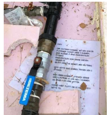
Figur 16: Tilgjengelig informasjon plassert ved inntaket fra Kjerstivatnet.
